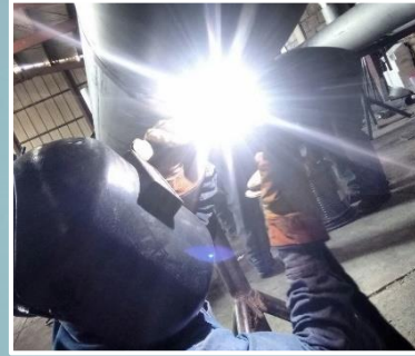
Servicios técnicos industriales
