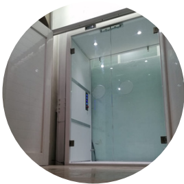
ELEVADOR RESIDENCIAL, GUANAJUATO.
