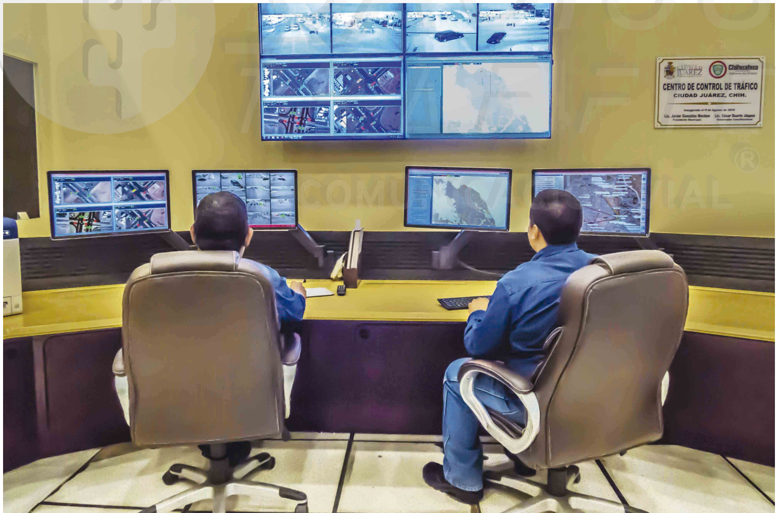
Centro de control de tráfico instalado en Cd. Juárez, Chih.
