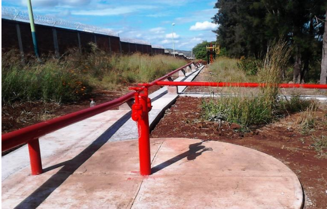
HIDRANTE CONTRAINCENDIO TAR JALISCO
