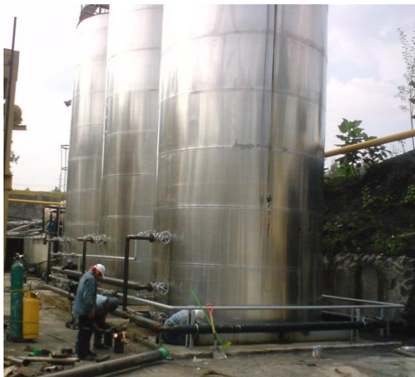
3 TANQUES 100 MIL LTS DE ASFALTO CON SERPENTÍN, AGITADOR, AISLANTE, SIST. AUTOMÁTICO DE LLENADO, MEZCLA Y BOMBEO
