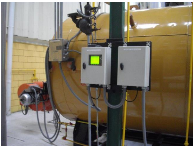
QUEMADOR A GAS NATURAL, CON CONTROL DE CO, O 2 Y VARIADOR ARCA CONTAL - MATAMOROS, TAMP.
