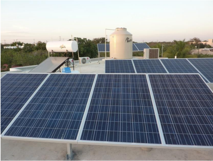
MÉRIDA, ENERO 2015, CASA INTEGRAL CON 13 PANELES SOLARES + CALENTADOR SOLAR DE 240 LITROS + CERO SARRO
