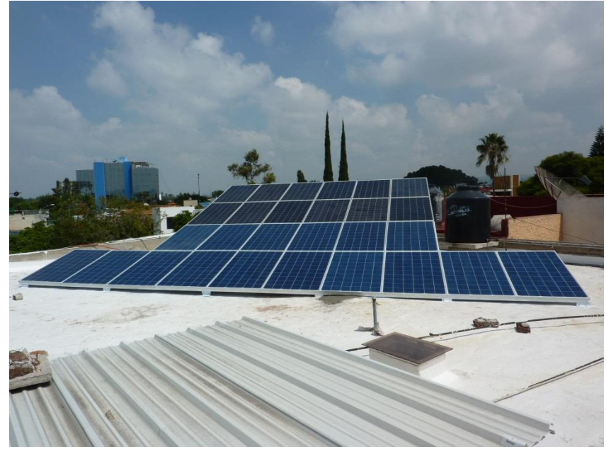
QUERÉTARO, AGOSTO 2015, NOTARIA 7 kW 26 PANELES DE 250W
