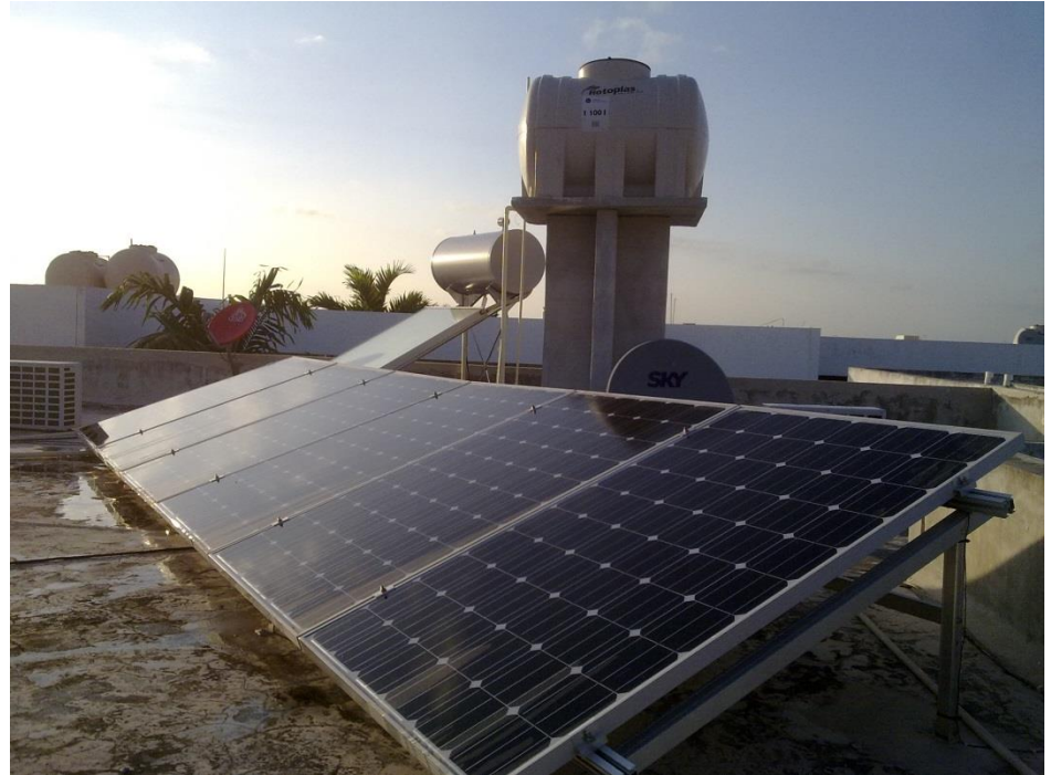
MÉRIDA, NOVIEMBRE 2014, CASA INTEGRAL CON 6 PANELES SOLARES + CALENSOL ORO DE 200 LITROS + CERO SARRO
