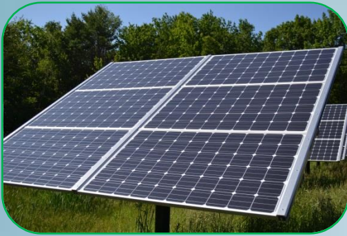
PANEL TIPO SISTEMA FOTOVOLTAICO DE 250 Watts
