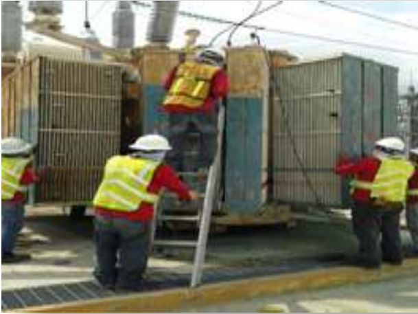
Mantenimiento Mayor a Transformador de Potencias Eléctricas CFE Subestación Felix U. Gómez Sep'13-Dic'13
