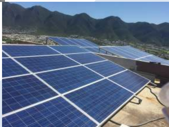
Instalación de Paneles Solares, Residencia en La Toscana, Monterrey, Nuevo León, México.
