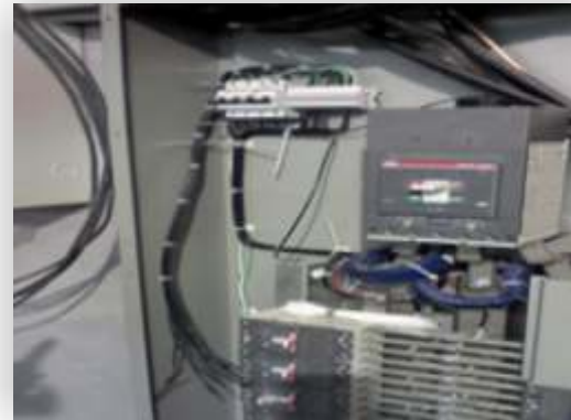
Proyecto CONAGUA (EPCCOR) Iluminación Sensores, Apagadores Tableros de Iluminación y Distribución Oct'14-Mzo'15
