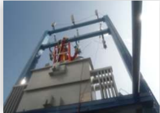
Mantenimiento a Subestaciones Eléctricas Propiedad de Servicios de Agua y Drenaje de MTY Ene'15-Mzo'15
