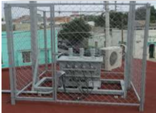
Desarrollo de Programa de Subestaciones Eléctricas con FIDE Desde el año 2012
