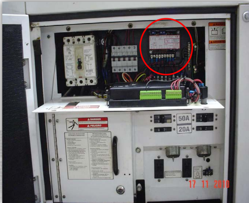
Suministro de control de gobernador para planta eléctrica con motor John Deere y con remolque y caseta acústica.
