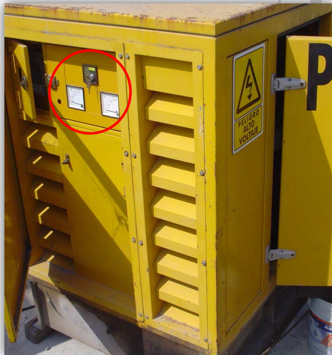
Control de motor y equipo de medición para planta eléctrica de operación manual
