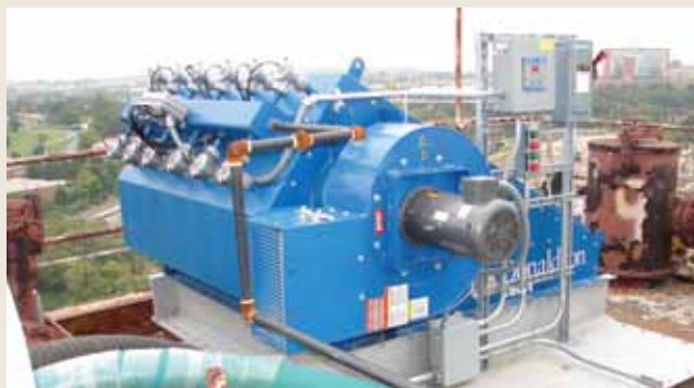
CPV Múltiples silos de cemento 4,800 cfm
