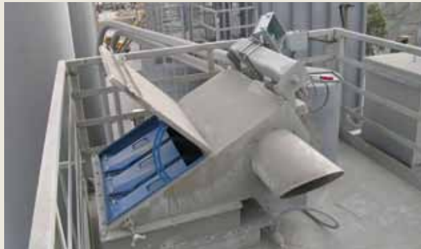
CPV Contenedor de almacenamiento de llenado neumático 1,200 cfm
