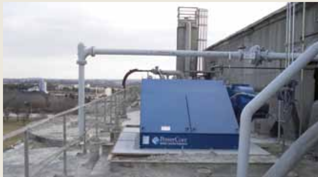
CPV Múltiples silos de cemento 4,800 cfm
