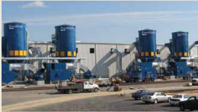
RF Instalaciones de muebles de Madera 403,000 cfm
