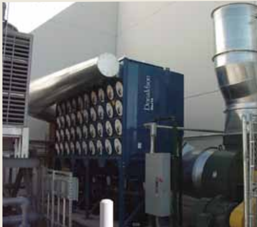
DFO Humos de soldadura 53,000 cfm Izquierda: fuera Derecha: dentro
